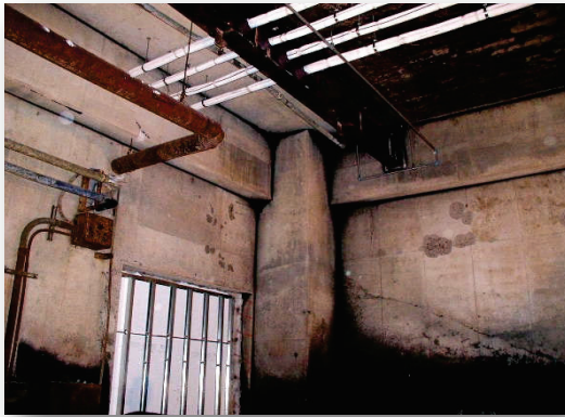
鉄筋コンクリート造の被害
