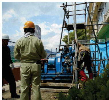
建物の傾斜発生要因の調査
