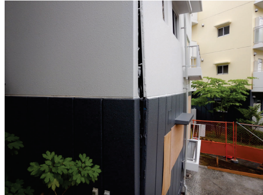
ガス爆発物件(PCa造)の被害
