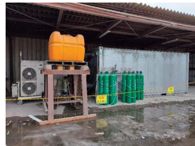
写真-1 炭酸化養生槽の例
