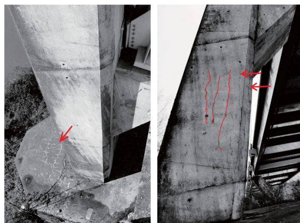
亀甲状のひび割れ
